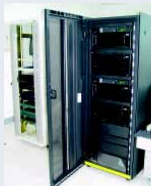
中心局域网主要设备 Primary equipment of local area network
